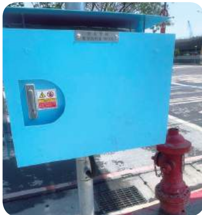
給水ネットワークパイプラインの圧力観測設備
