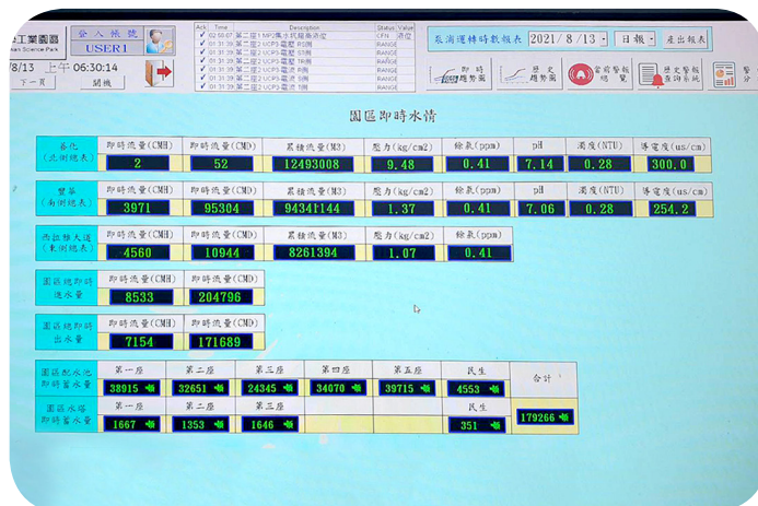
供水管網資訊智慧化監控
