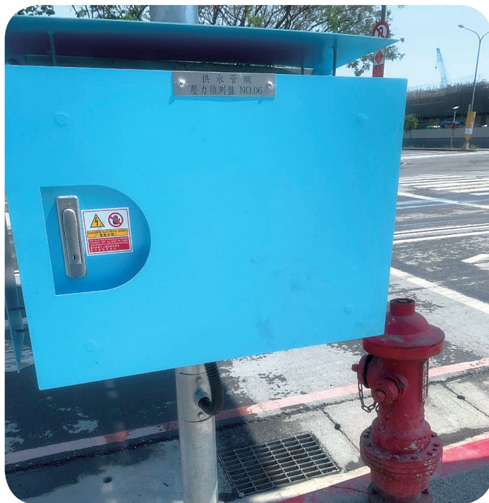
供水管網管線壓力監測設備
