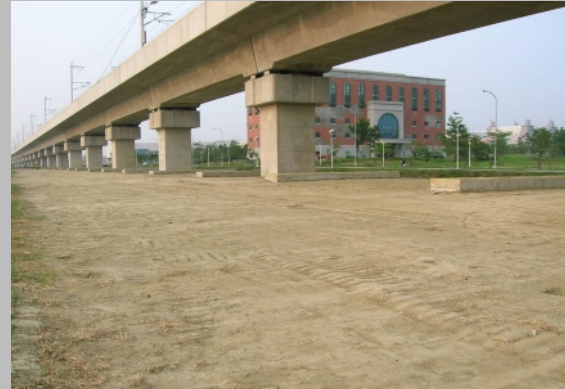
基礎構造強化工事完了後の現場(高鉄橋脚間の地下構造に施工、地面の突起している部分は振動減少连接器メンテナンス用マンホール)
