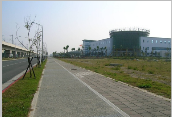
彈性減振牆完工後現地(施作於人行步道右側下方地層，上方已完成復舊作業)
